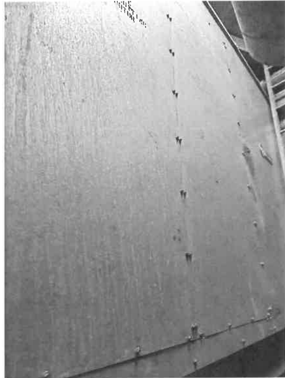
Photo 64: Auditorium Fan System
