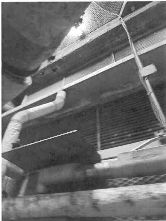
Photo 65: Auditorium Fan System
